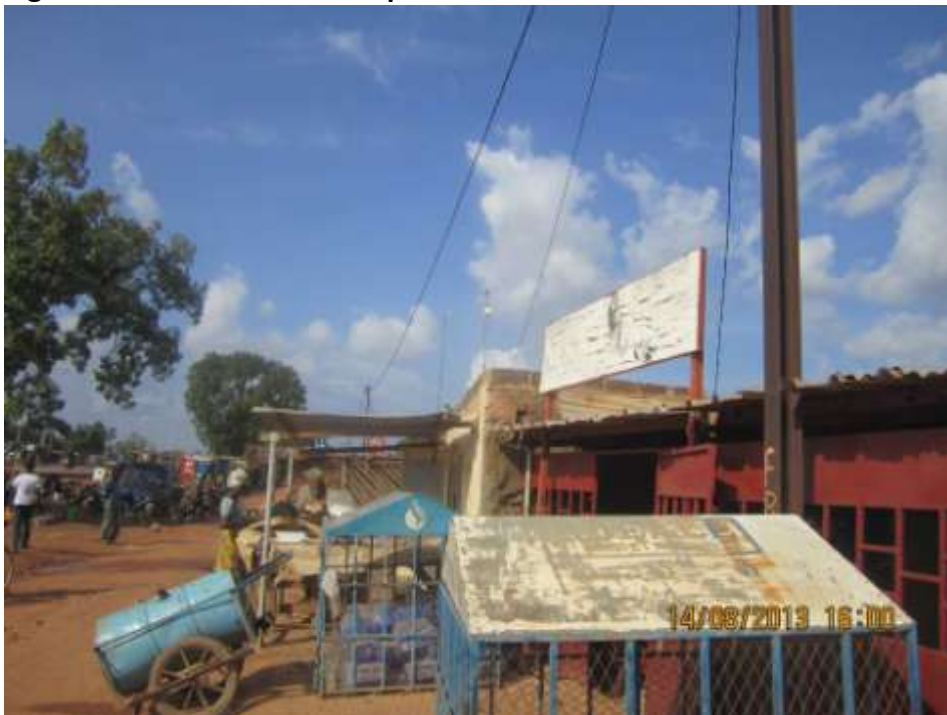
Figure 4 : Branchements temporaires au réseau de la SONABEL à Nioko 2
